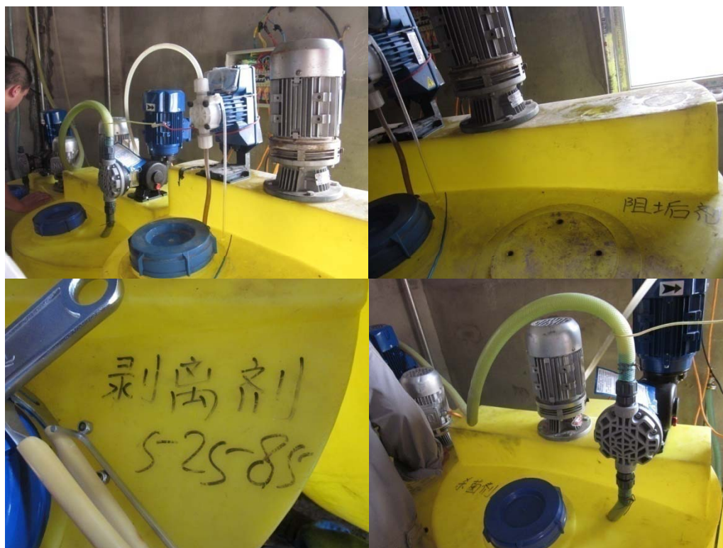
金隅集团河北某水泥厂剥离剂、杀菌剂、阻垢剂投加（MS1系列）
