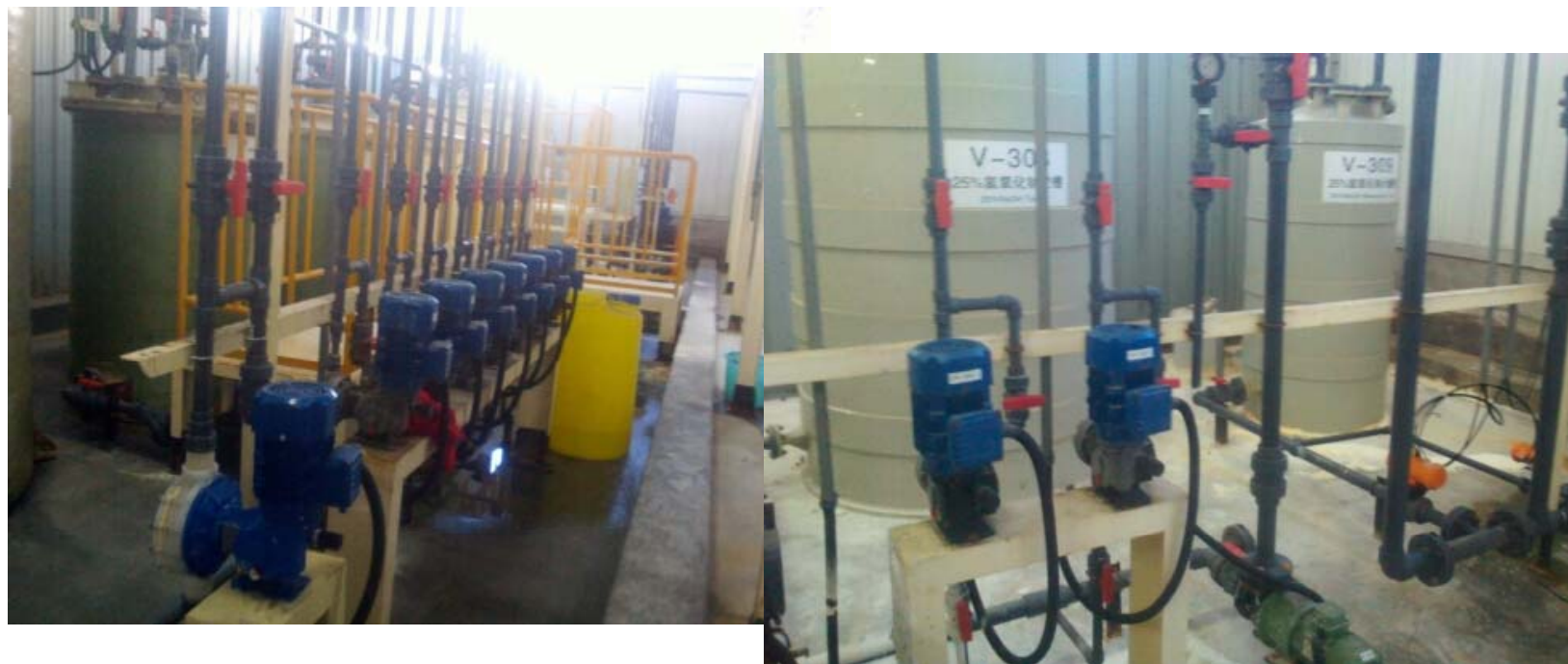
北京顺义区某汽车配件厂加药车间(MS1和MS3系列)
